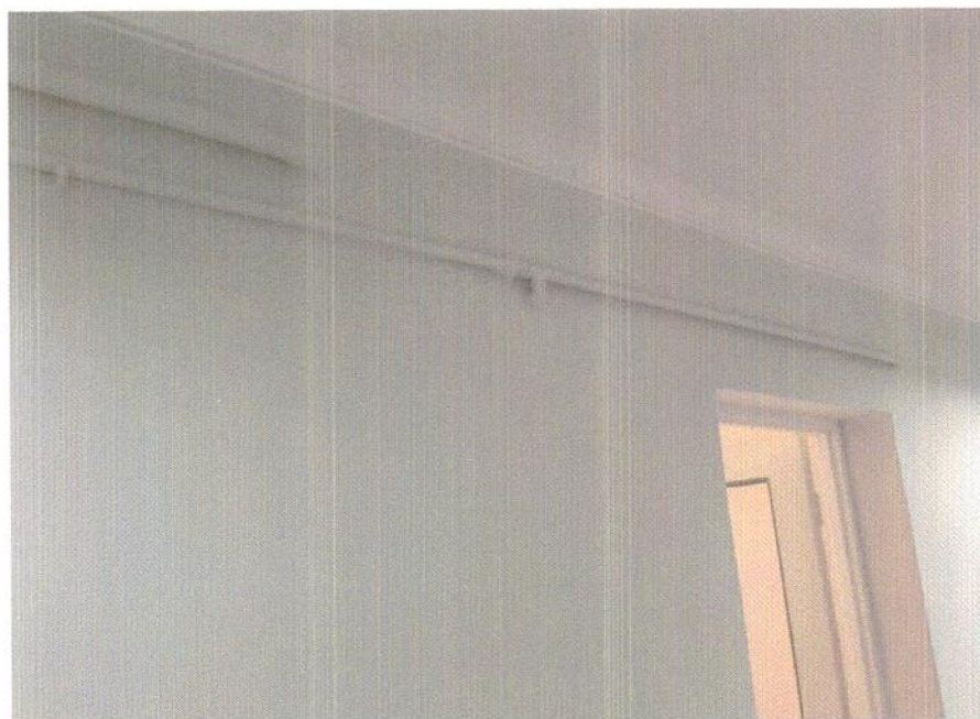
Fot. 5. Widok przewodu wodociągowego do przełożenia
