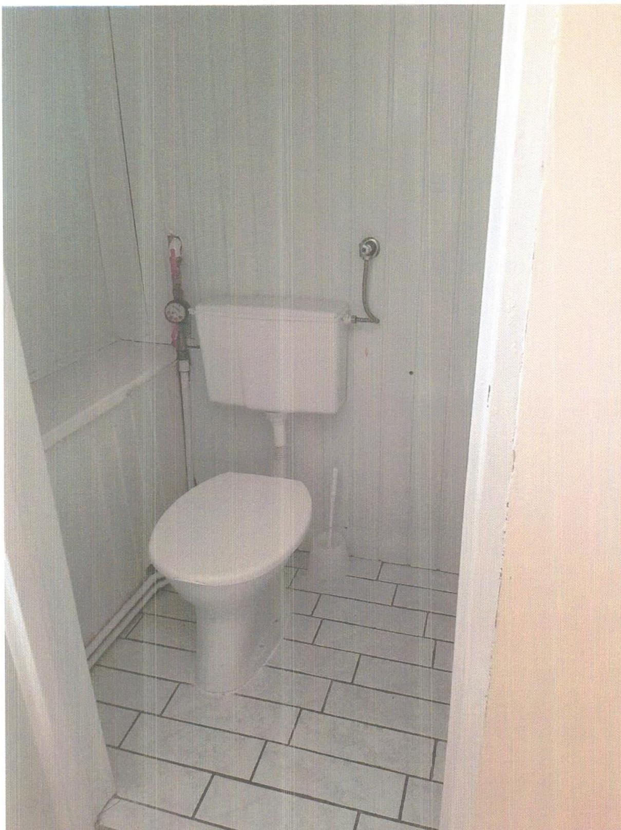
Fot. 1. Toaleta w części biurowej.
